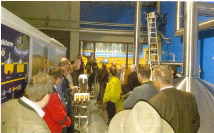
Blick ins Sudhaus mit der neuen Verrohrung für Dampf- und Heißwassersystem
